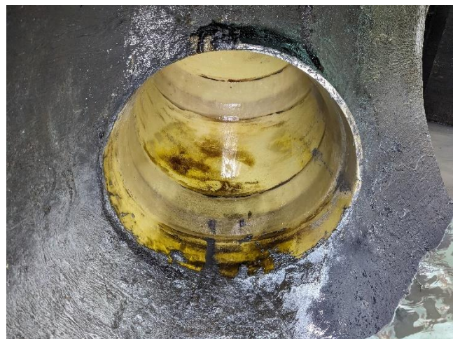
CS-12 drop pipe
