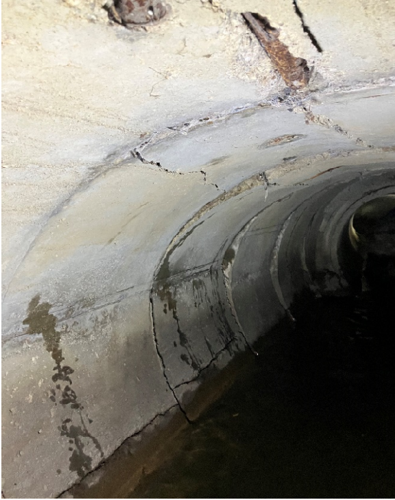
Longitudinal Pipe Cracks
