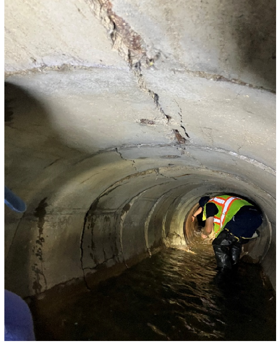
Longitudinal Pipe Cracks
